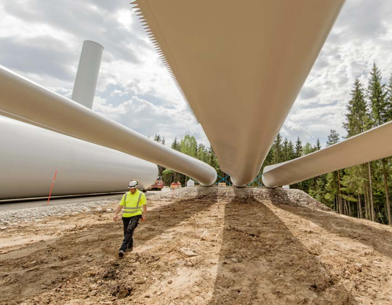
13 vindkraftverk har byggts i en park nära Grimsås. Nexans har levererat den kraftkabel som tar energin ut i elnäten och den optokabel som krävs för att styra vindkraftverken. Vindkraften står i dag för runt 20 procent av Nexans elnätsaffärer.
