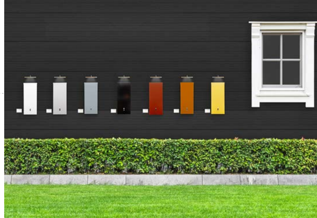
Nexans har skapat nya snygga fasadskåp som tar fiber till hemmet in i villan eller radhuset.
